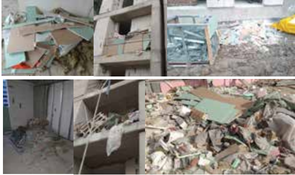
Şekil 7 : İmalat Sonrası Oluşan Atık Alçı Levhalar
